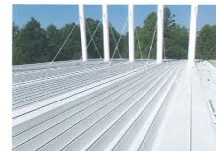
美術館 (福井県) 折板屋根 (遮熱・消音)
